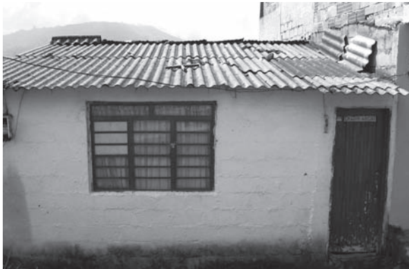
FOTO 13. Unidad básica entregada por el municipio después de unos años. Fuente: Anne-Catherine Chardon.
