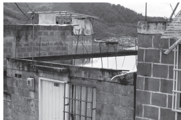
FOTO 28. Problema de humedad en la cubierta. Fuente: Anne-Catherine Chardon. PICTURE 28. Rooftop with humidity problems. Source: Anne-Catherine Chardon.
